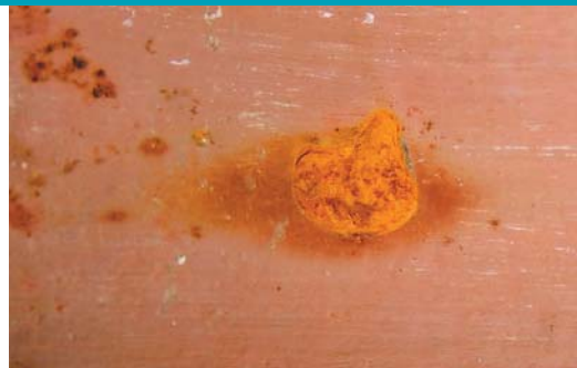
Рис. 4. “Язвы” коррозии на фальшкиле
