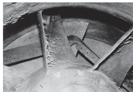
Попадание постороннего предмета в рабочий орган движителя, оборудованного защитной решеткой
