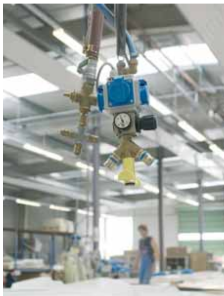
Штуцеры вакуумной системы во множестве свисают с потолка цеха
