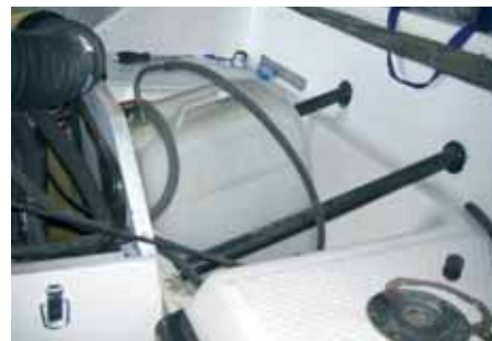
Кроме болтов, крепящих блок к транцу, дополнительную жесткость соединения обеспечивает пара стальных труб
