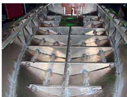
Здесь конструкция не обеспечена должным запасом прочности: ребра жесткости из «лежащего» уголка, шпангоуты не «перевязаны» по всей своей ширине
