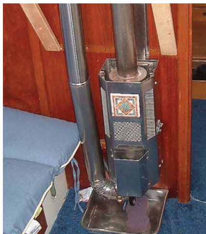
Дизельная/керосиновая печка «Sig Marine» со сбалансированной тягой (дополнительная труба для подвода наружного воздуха расположена слева от корпуса). На этой яхте печка работает на керосине, поступающем от 10-литрового суточного бачка по топливному шлангу с резиновой грушей для подкачки. Печка установлена в соответствии с инструкцией, как можно ниже. Недостаток – еще одно отверстие в палубе.
