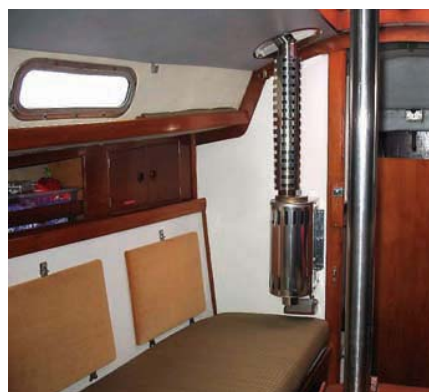
Переборочная дизельная печка «66 MW» фирмы «Refleks Olieovne A/S», Дания. На дымоходе установлено защитное ограждение.
