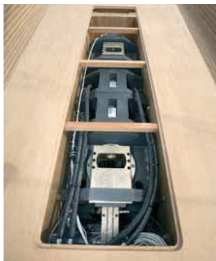
Под настилом кокпита прячется гидравлика подъема килля
