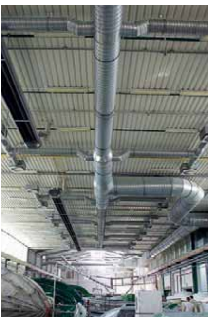
Системы вентиляции и очистки воздуха на крупных современных верфях – это очень сложные и дорогие установки
