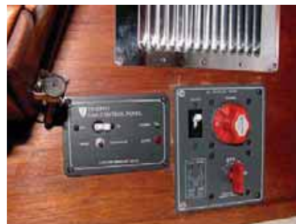
Рис. 11. Щиток контроля яхтенной газовой системы (слева) фирмы «Trident», США, и щиток управления аккумуляторной системы электроснабжения (справа).
