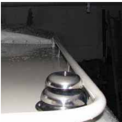
Рис. 6. Коаксиальный дымоходный дефлектор отопителя «Dickinson Newport» на хардтопе катера
